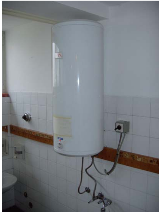
Slika 13 Primjer: električni bojler u DV "Vladimir Nazor" u Zagrebu, iako je vrtić spojen na gradski centralni toplinski sustav. Vidi se dodatna sklopka koja bi trebala spriječiti česta iskakanja električnih osigurača.
