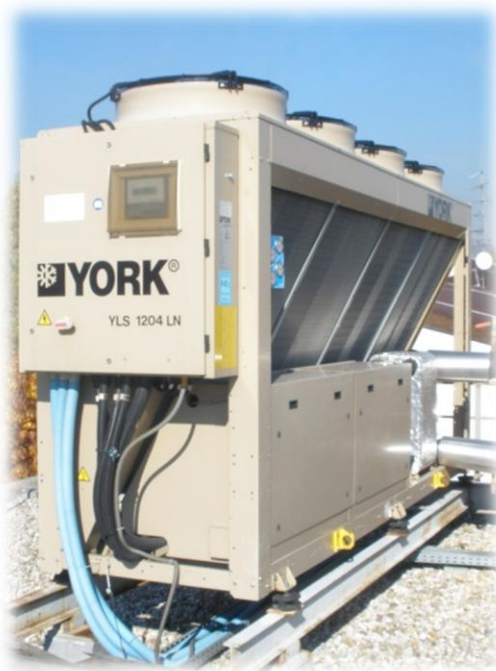
Slika 2.26 Rashladnik vode na objektu Paviljon 4
