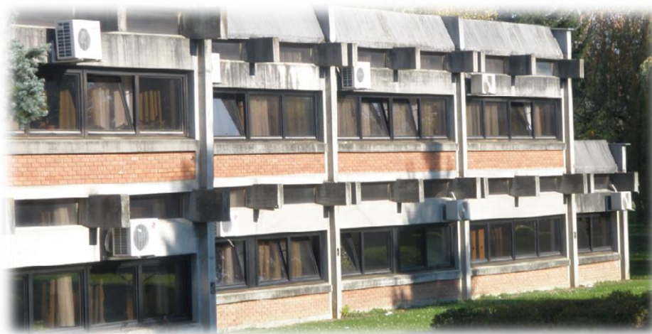
Slika 2.25 Vanjske jedinice na objektu Srednja policijska škola
