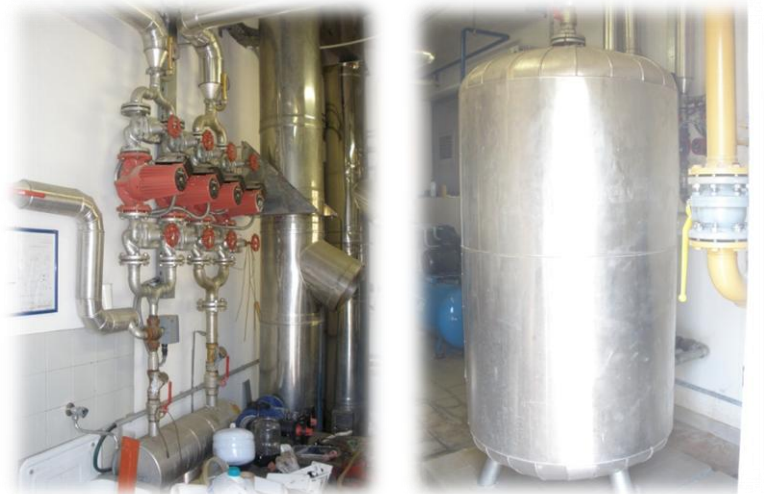
Slika 2.22 Razdjelnik toplinske podstanice 7 i spremnik tople vode
