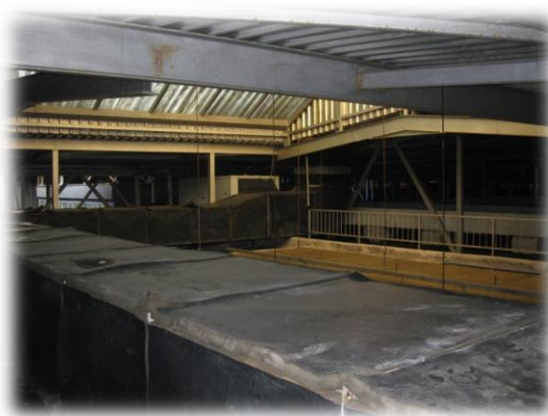
Slika 2.30 Ventilacijski kanali u potkrovlju objekta Kuhinja i restoran
