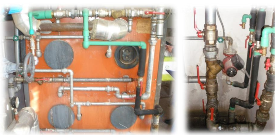
Slika 2.17 Akumulacijski bojler i recirkulacijska pumpa
