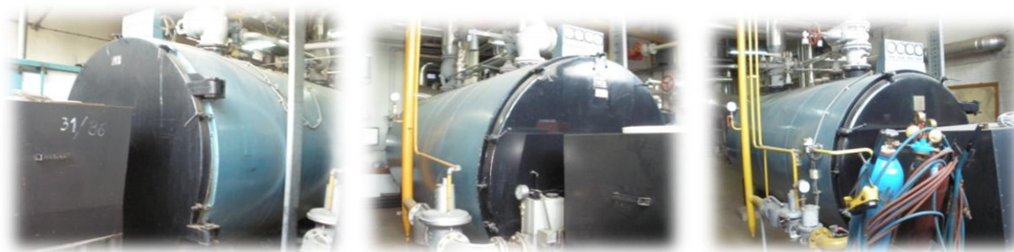
Slika 2.9 Vrelovodni kotlovi u kotlovnici
