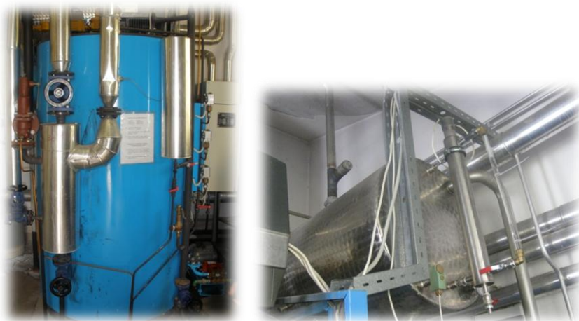
Slika 2.23 Parni kotao i spremnik kondenzata
