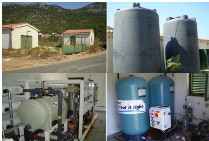
Slika 13. Desalinizacijsko postrojenje na Mljetu-postrojenje Blato (31)
