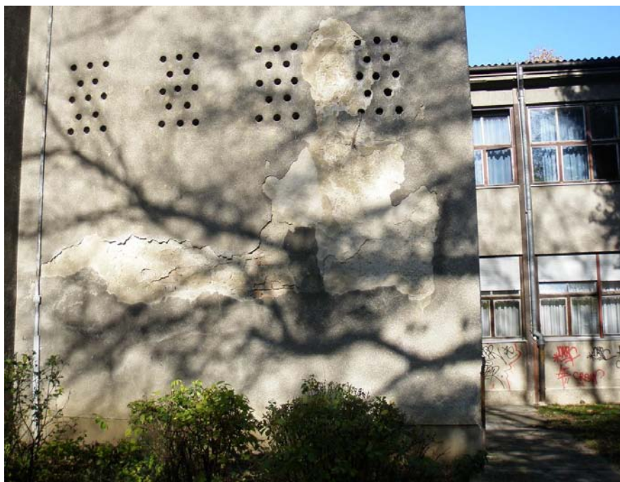
Slika 3. 1: Oštećena i otpala žbuka na fasadi školske zgrade
